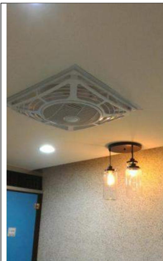
圖 13-5 廁所內採機械換氣，減少廁所臭味。 (來源：張志源拍攝)
